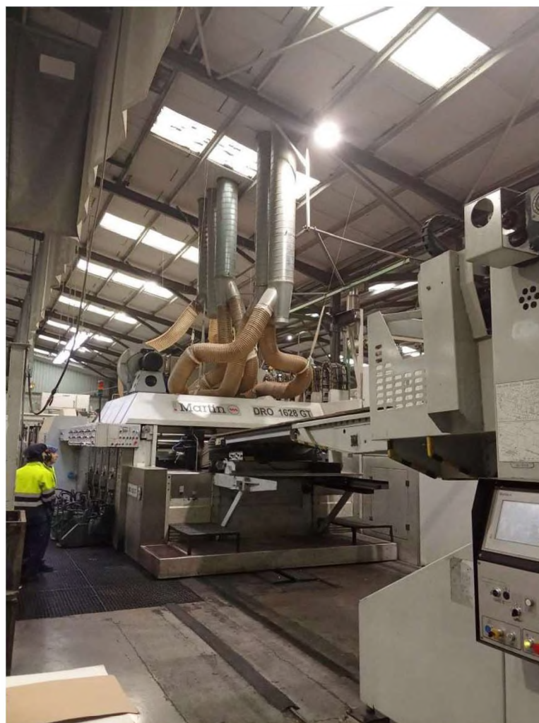
Imatges sortida aire DRO 2, sacs aspiració i expulsió retall
