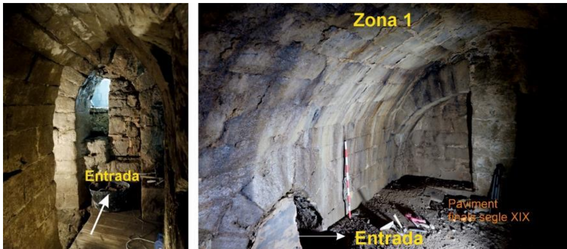
Figura 15: Vista de l'entrada a la volta des de l'interior de les adoberies de la Rambla Ferran, 9. Observis el tapiat i l'obertura realitzada per accedir-hi. A la dreta, vista des de l'interior de la part superior de la porta d'arc apuntat.
