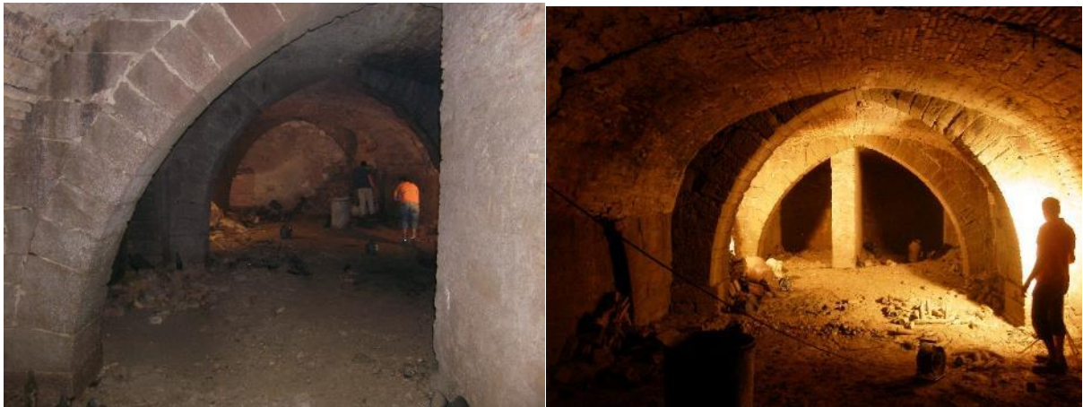
Foto 7a: Voltes de l'adoberia 5. Al fons arcada amb tapiat de finals de segle XIX per on s'accedia al soterrani -2 de la casa de l'adober. 7b,c i d: vistes de l'estat actual de l'interior del soterrani.
