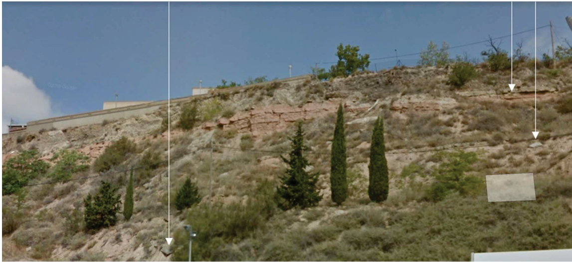
Caiguda de blocs en el vessant sud del castell de Gardell, limitant amb la N-II
