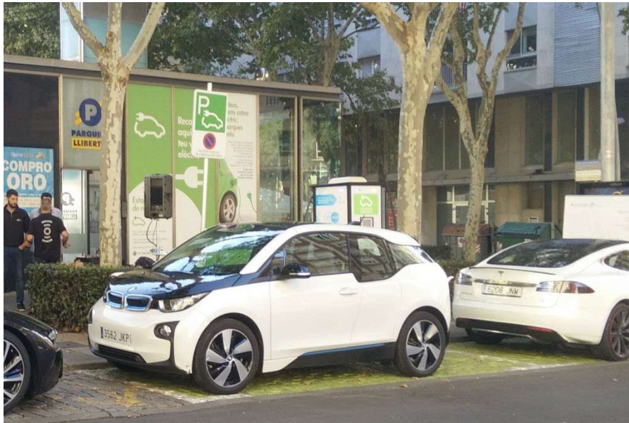
Exemple de places reservades per vehicles elèctrics
