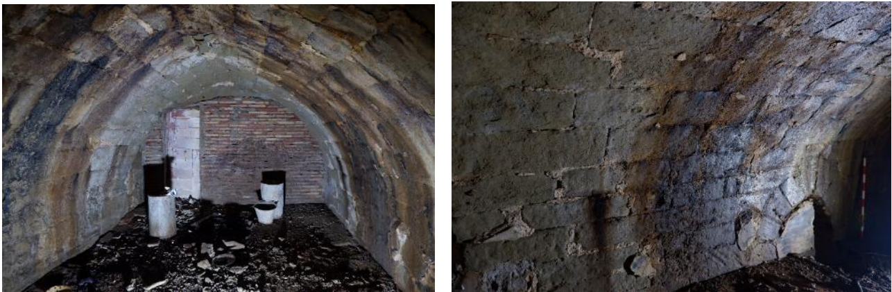
Figura 16: Foto esquerra: Observis la paret de fons de tancament de l'espai amb el tapiat de maons i una antiga porta actualment tapiada. Foto dreta: detall de l'estat de l'intradós de la volta amb les concrecions calcàries i les aigües residuals que han tacat el parament.
