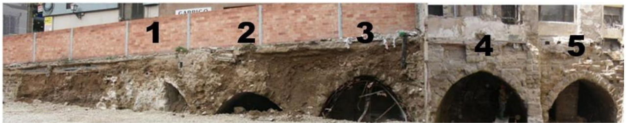
Foto 10: Muntatge fotogràfic de les voltes d'accés a les adoberies localitzades sota el carrer Blanquers (any 2004 i 2006) Voltes 1,2 i 3 dels edificis Rambla Ferran 3,5 i 7 (adoberies 2,3 i 4) seccionades en fer el mur pantalla i sense documentació arqueològica avui dia conservades darrera del mur de façana de l'edifici. Voltes 4 i 5 pertanyent a les adoberies 5 i 6 excavades actualment
