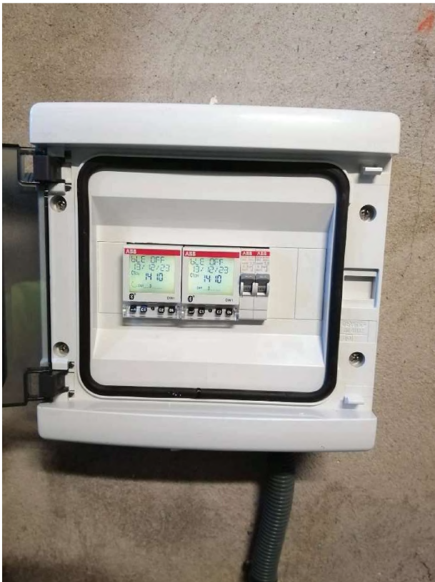
Imatge 1: Interruptors horaris instal·lats
