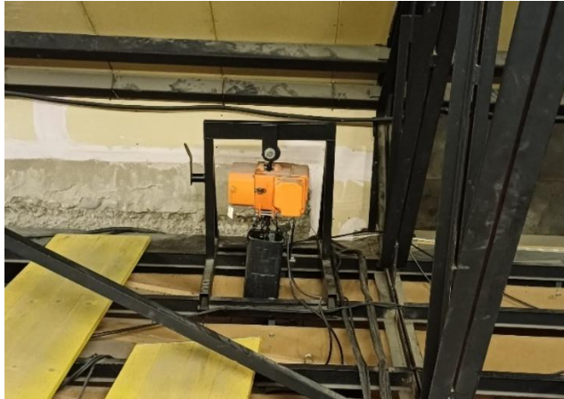
Imatge estat actual polispast de cadena sobre estructura sostre sala 1
