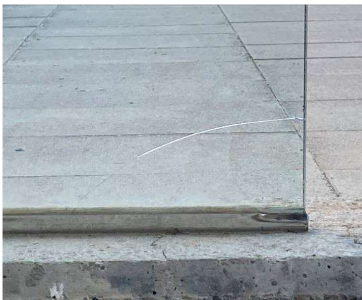
Trencament de vidre fixe
