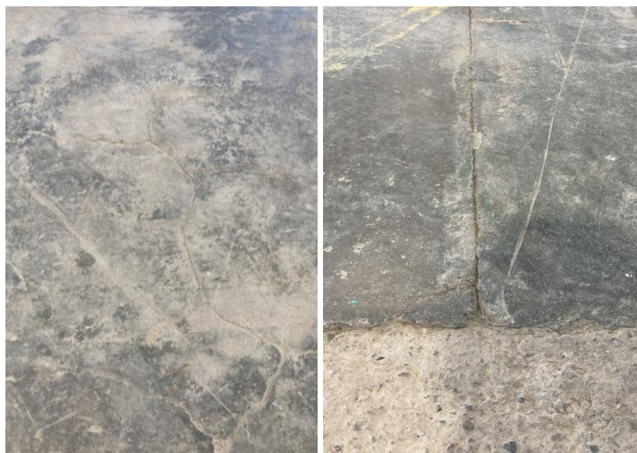
Estat actual solera de la pista polivalent
