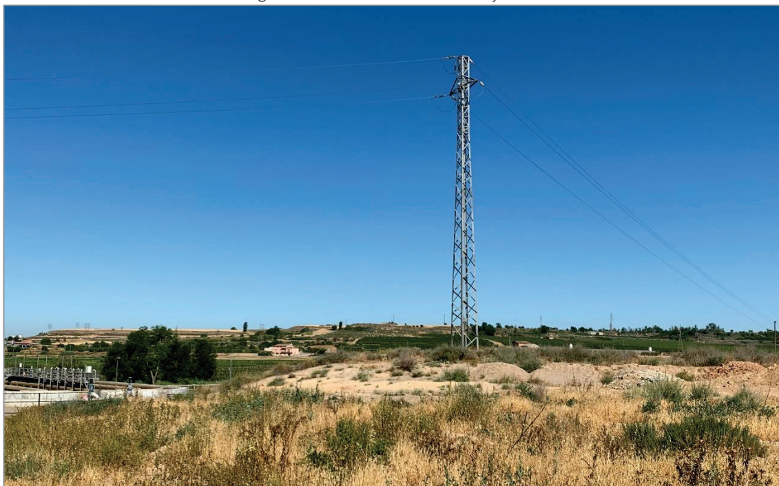
Fotografia 132. Línia elèctrica de mitja tensió.
