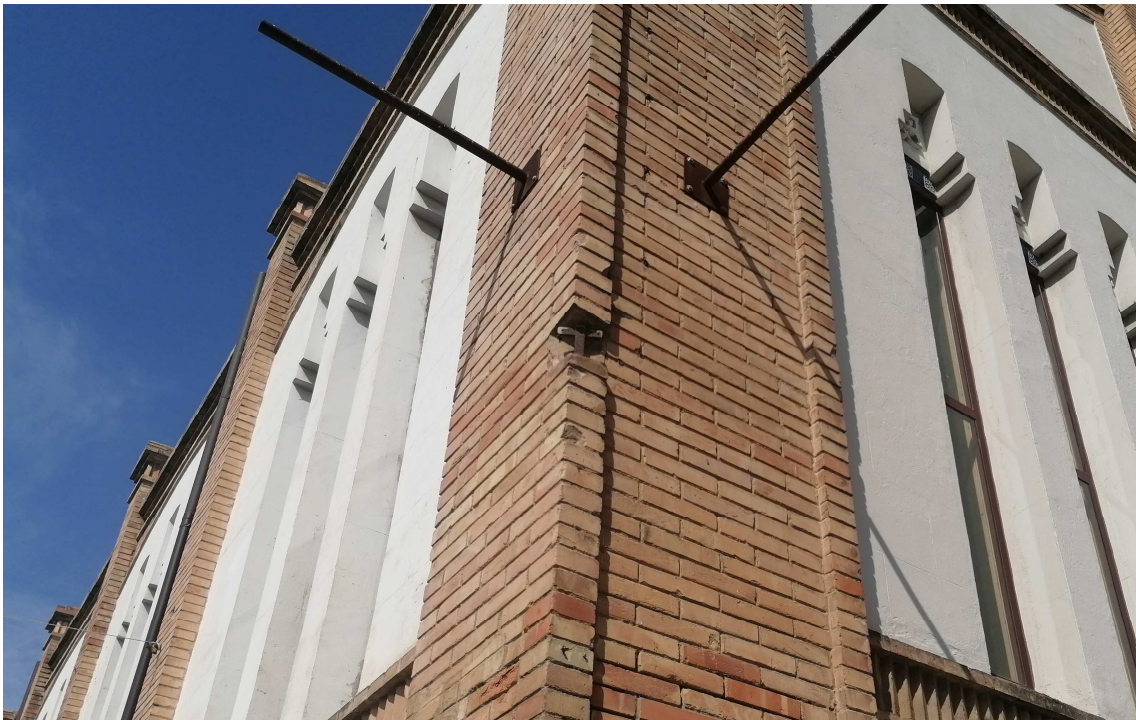
Fotografia 04_ Detall peces ceràmiques deteriorades.
