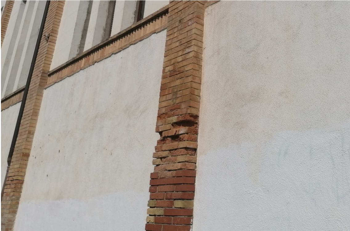
Fotografia 05_ Detall peces ceràmiques deteriorades.
