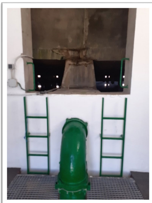
FOTOGRAFIA NÚM. 10. INTERIOR CAMBRA VÀLVULES DIPÒSIT
