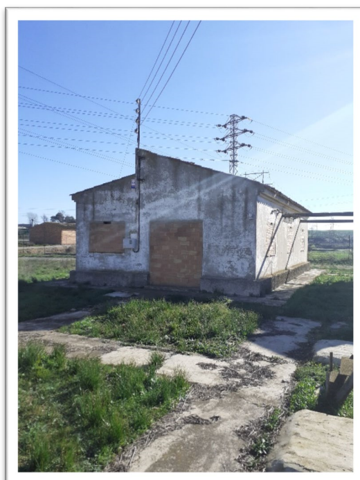
FOTOGRAFIA NÚM. 8. CASETA AMB COMPTADOR ELÈCTRIC
