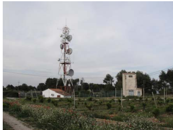
Imatge 28. Antenes de comunicació distribuïdes pel Pla de les Torres. (Abril, 2011)
