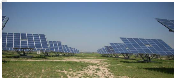
Fotografia Parc Solar de 1,3MW a Navarra amb seguidors Mecasolar
