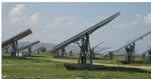
Fotografia Parc Solar de 1,3MW a Navarra
